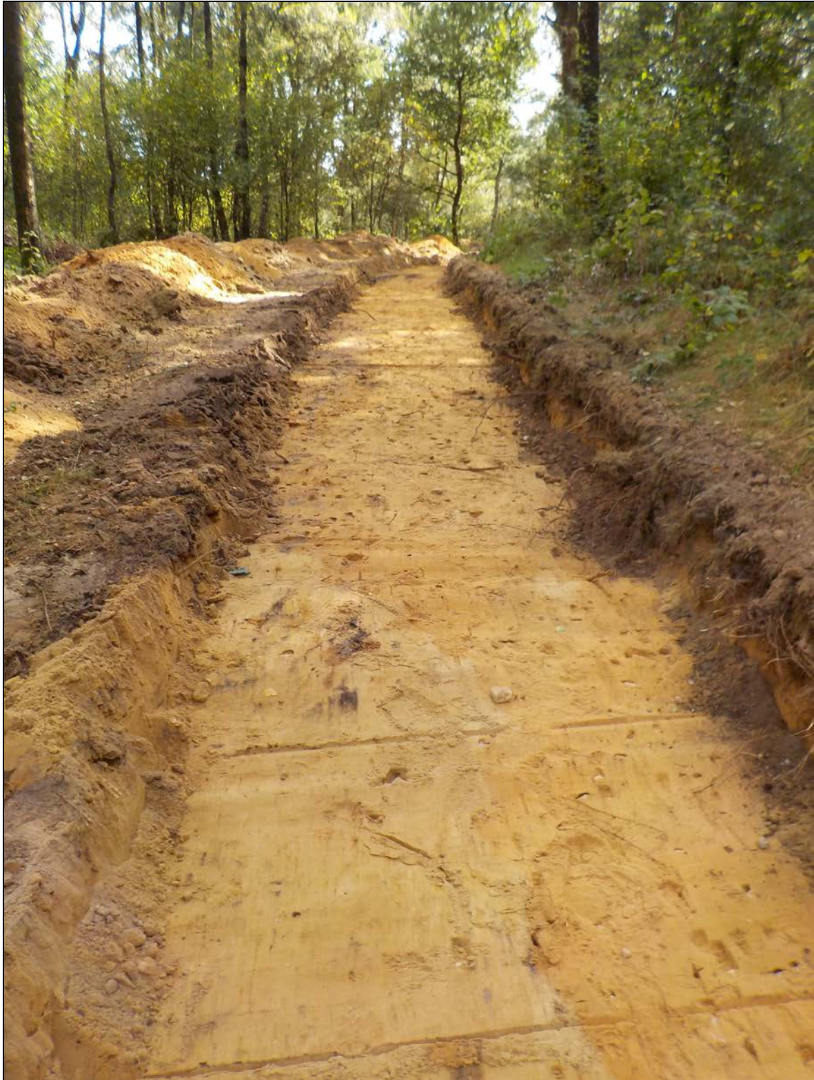
Afbeelding 18. Overzicht van de op 16 september 2016 gegraven leidingsleuf. De foto is genomen vanuit noordwestelijke richting.
