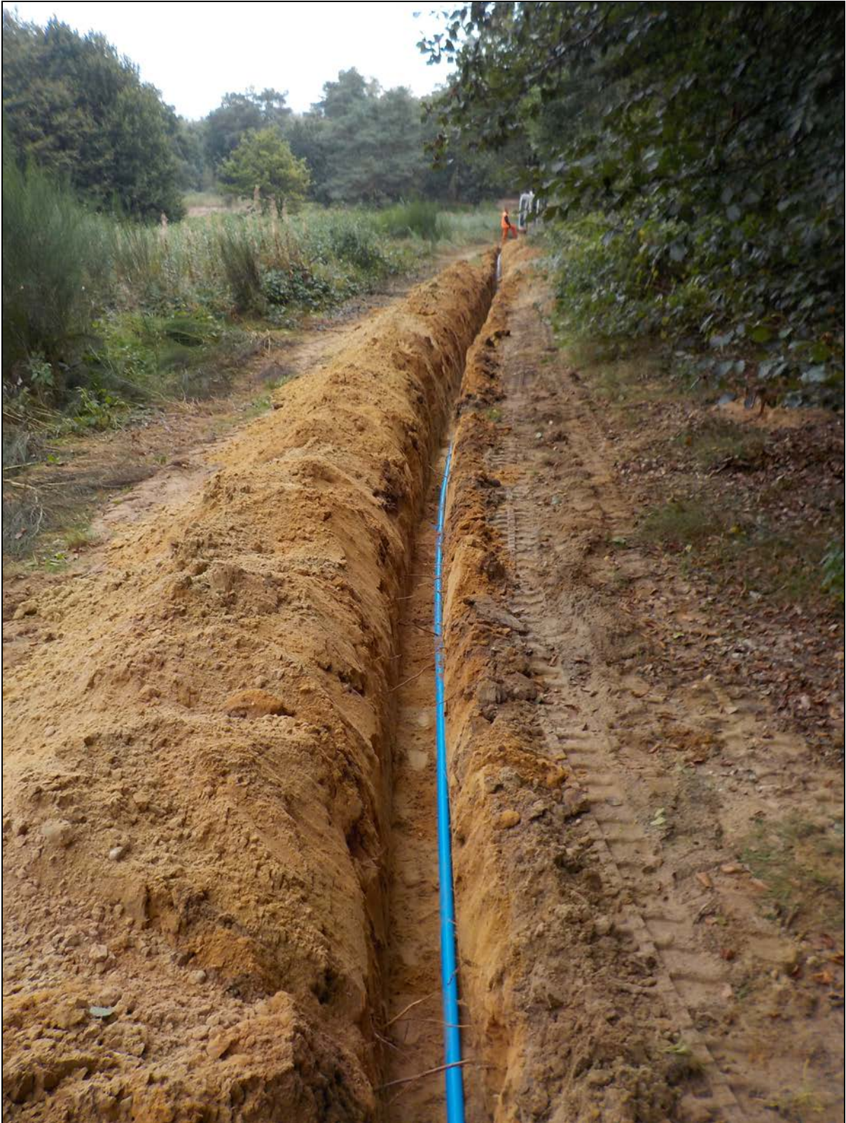
Afbeelding 19. Overzicht van de op 4 oktober 2016 gegraven leidingsleuf. De foto is genomen vanuit noordwestelijke richting.
